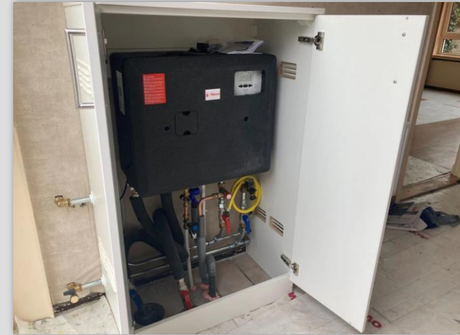
Afleverset in de woning (bron: warmtenetgorinchem.nl)
