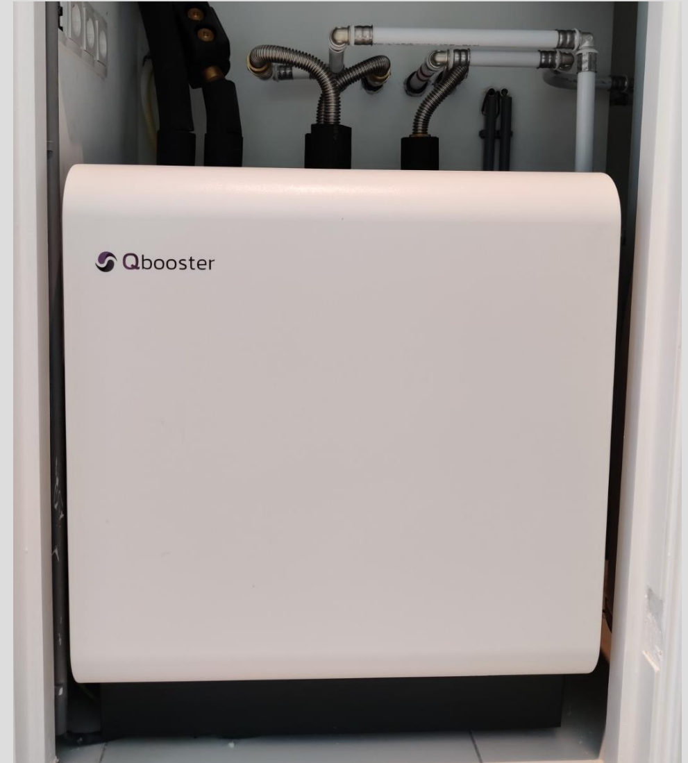
Boosterwarmtepomp in de woning voor tapwater.
